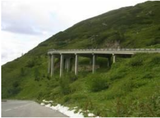
Figura 41. Solución en viaducto que evita grandes desmontes y terraplenes en una curva de radio mejorado en la carretera Grossglockner
